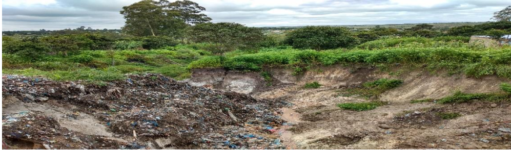
Figura 1 Ravina formada no entorno do Aterro.
