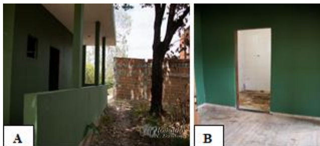
Figura 7(A e B): Instalações abandonadas situadas no Parque.
